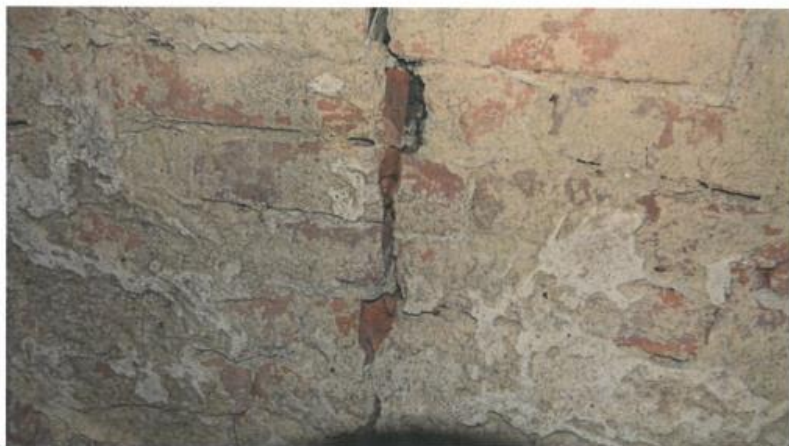
Zdj.10. Pęknięcie sklepienia na części północno-zachodniej stropu
