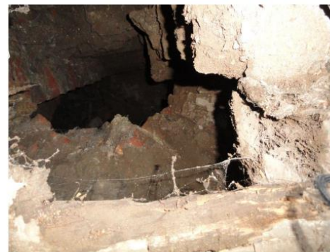
Uszkodzenia podłogi parteru
